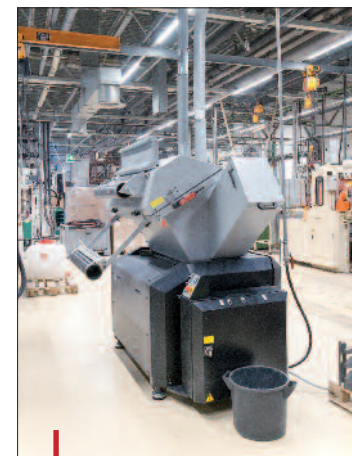
Les déchets de thermoformage sont renvoyés dans un broyeur Rapid.
