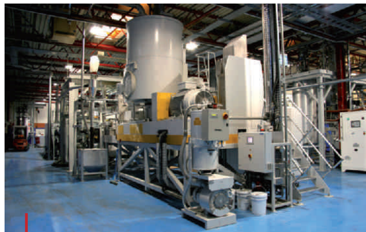
L'installation Erema-SML dans l'usine Kobusch de Stanley en Grande-Bretagne.
