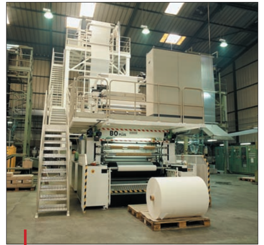
Cette ligne de coextrusion Macchi 3 couches a récemment été installée dans l'atelier.
