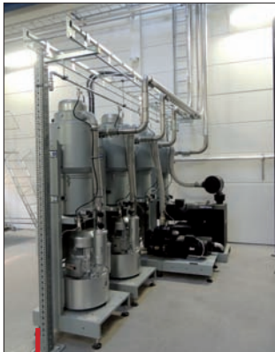
Plastic Systems est un spécialiste de la gestion centralisée des matières. MAT dispose de son équipe technique pour le montage et l'entretien de ces installations.
